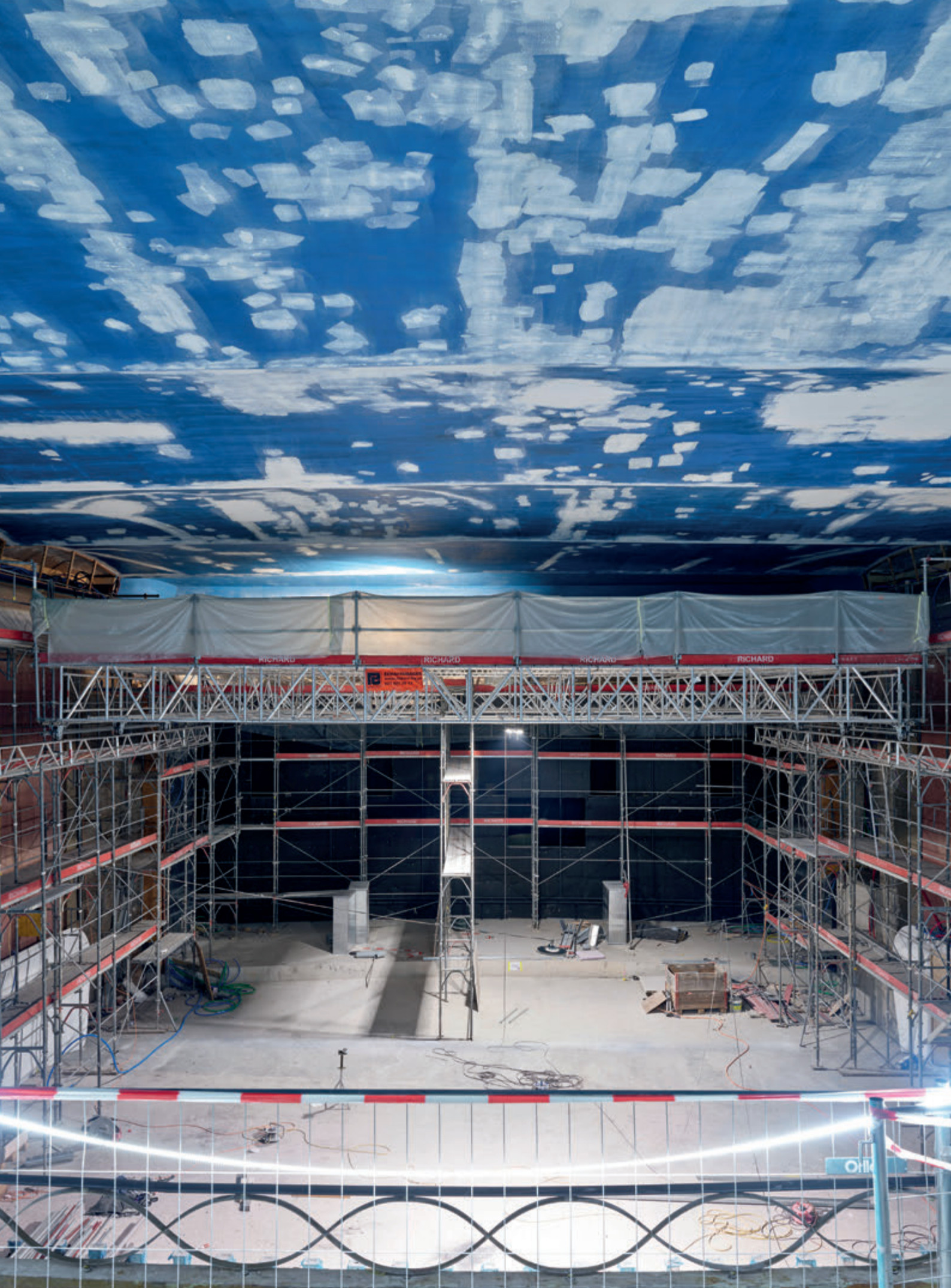
Baustelle des historischen Kinos Capitole in Lausanne, wo ab 2024 alle Filmvorführungen der Institution gezeigt werden.
